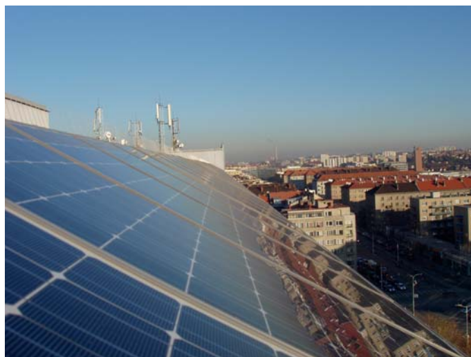
Fotovoltaická elektrárna na střeše budovy ministerstva
